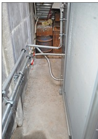
De achterzijde van de ventilator is voorzien van een fijn rooster om vervuiling tegen te gaan
