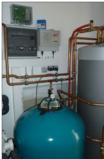
Installatie technische ruimte
