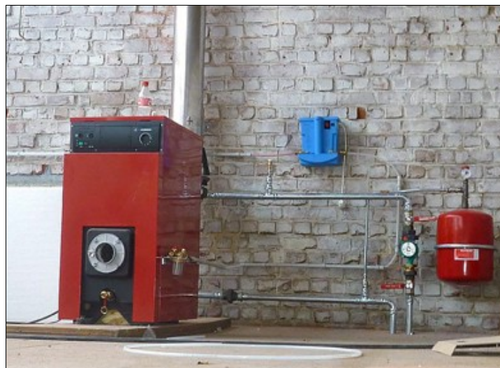
De ketel staat in de naast de zwembadruimte gelegen plaats
