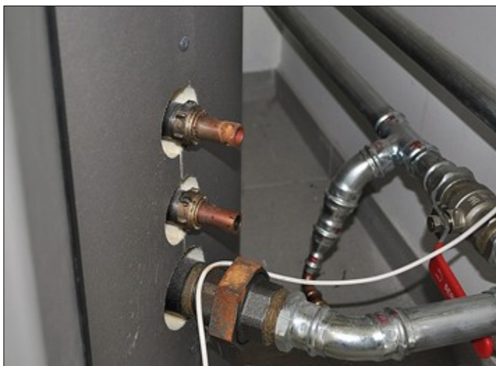
Aan de CTC-tank zijn er diverse aansluitingsmogelijkheden, o.a. voor bv. zonne-energie
